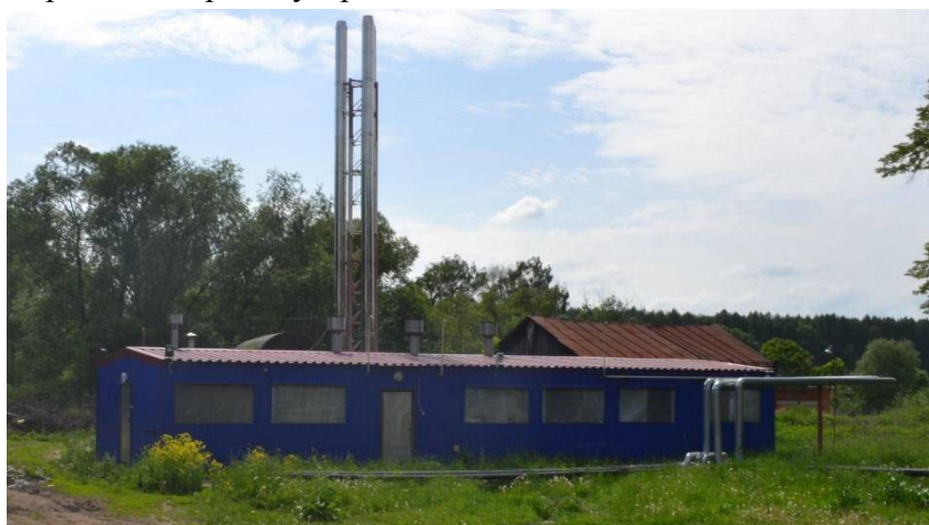
Рисунок 1.27 – Общий вид котельной «Зименки»
